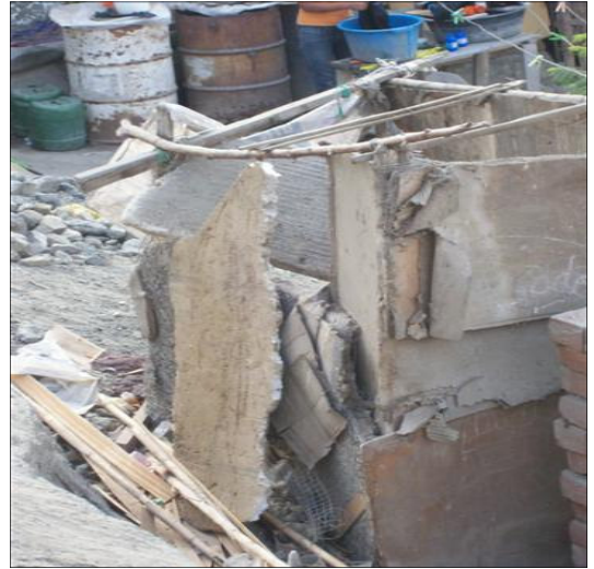
Latrine in Las Lomas de Canto Bello
